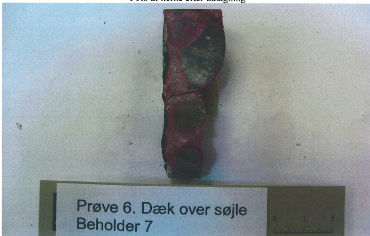
Foto af overfladestykke efter udskæring og påsprøjtning af phenolphthalein
